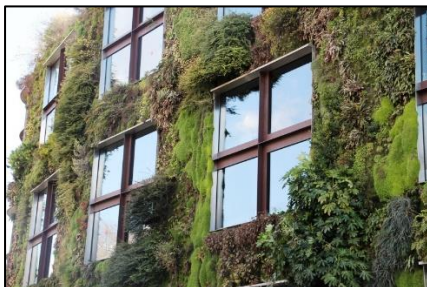
Figuur 9-3. Voorbeeld van een groene gevel.
