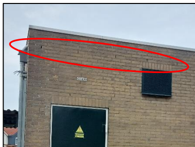
Figuur 5-2. Open stootvoegen bij elektriciteitshuisje op de onderzoekslocatie.
