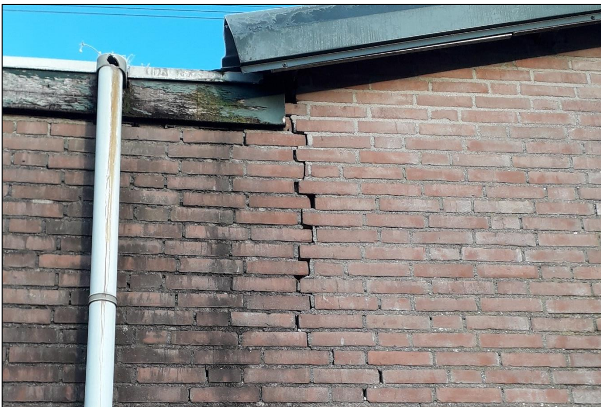
Figuur 5: Paardenstal met scheuren in de gevel aan de zuidkant van het gebouw.
