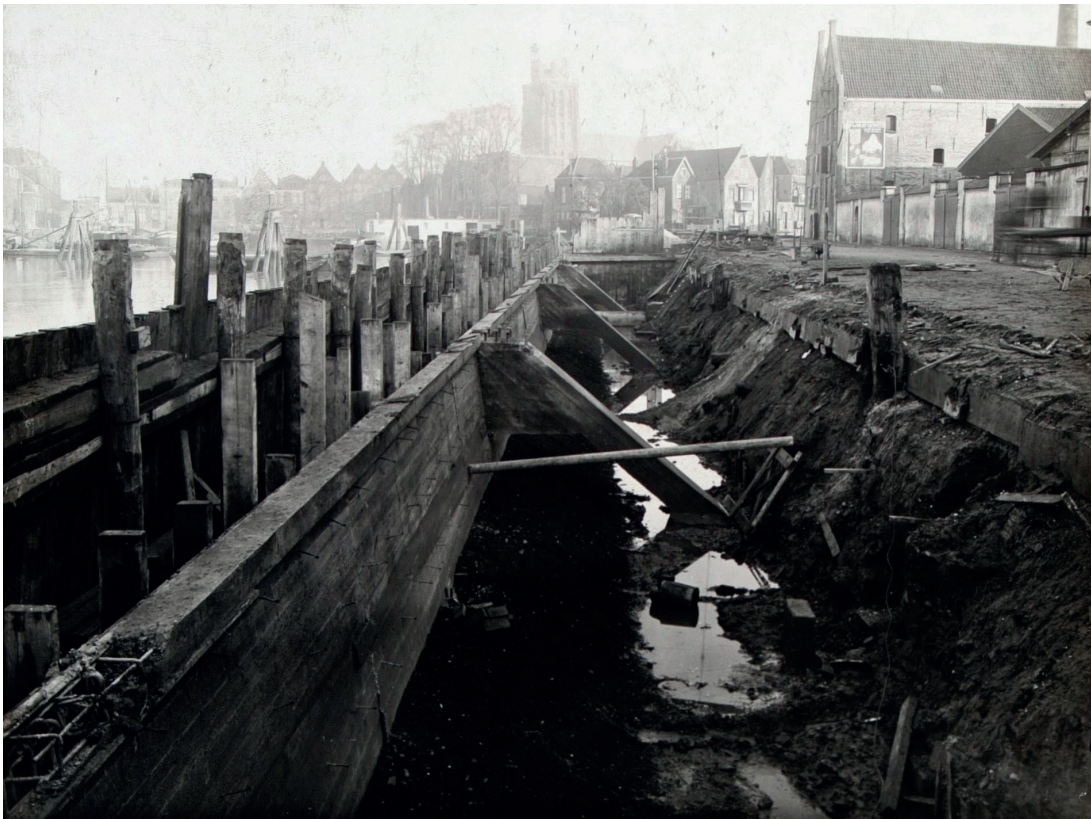
Afb. 16. De aanleg van de (huidige) betonnen kade van de Kalkhaven-Achterhakkers in de periode 1920-1930. Aan de voor-/waterzijde is mogelijk de oudere houten kadebeschoeiing te zien. Ook is duidelijk de bodem direct achter de huidige kade tot een diepte van circa 2 á 3 m -mv uitgegraven (RAD inventarisnr. 554_10171).
