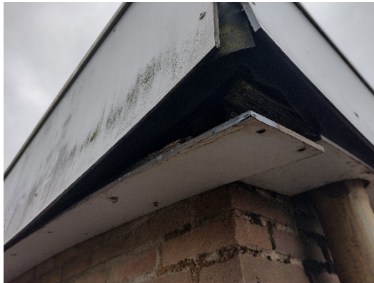
Foto 3: Enige locatie waar dakconstructie open is. De ruimte achter de opening is permanent vochtig en dus niet geschikt voor beschermde verblijfplaatsen
