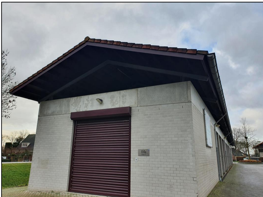
Figuur 2 De materieelopslag bevat verschillende open stootvoegen en kierende kantpannen.
