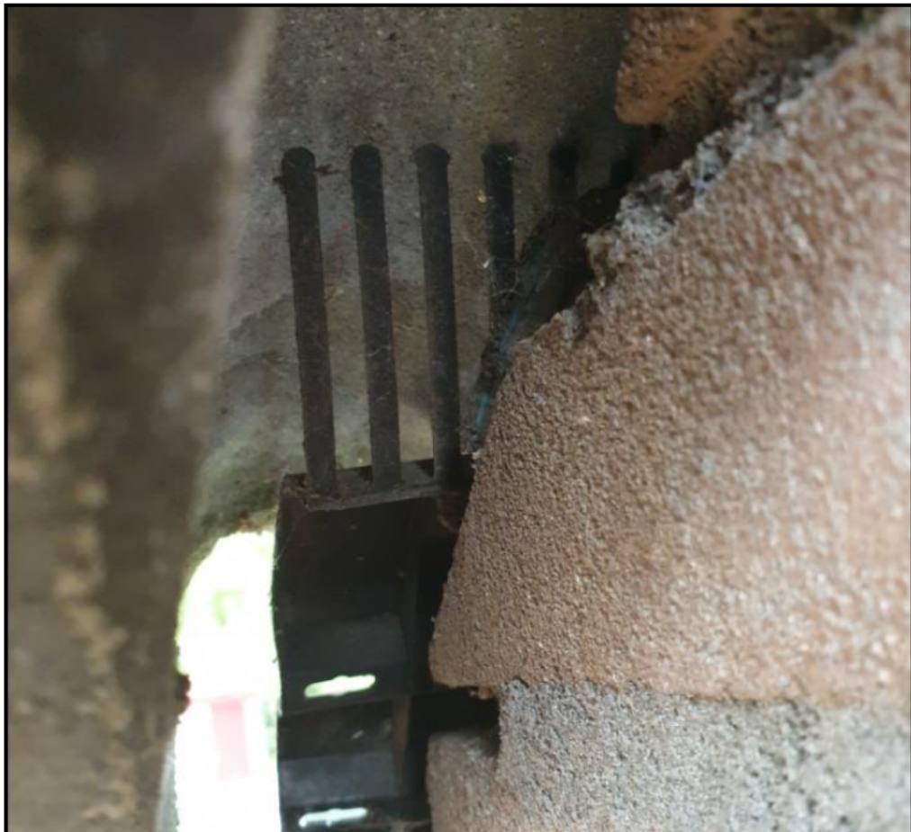
Figuur 1 Achter de dakgoot bij de bebouwing gemarkeerd met '3' in figuur 1 is vogelschroot aanwezig
