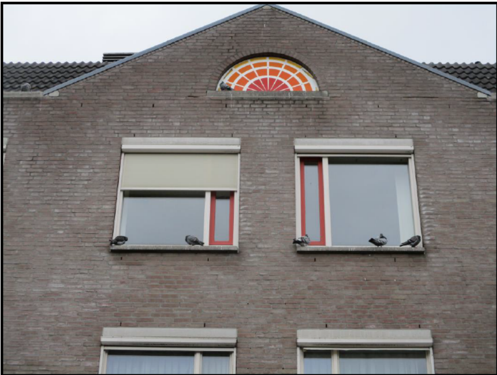
Figuur 4 Een aantal van de vele open stootvoegen op de bebouwing binnen de planlocatie.
