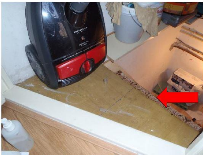
Figuur 17: Asbest aangetroffen bij Dubbeldreef 49 (Complex 536) in een vinylzeil dat als vloerbedekking in 2 kasten van de 1 e verdieping wordt gebruikt. Bron: Asbestrapport 536 447111.
