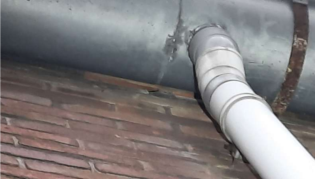
Detail van een gevel in complex 542. De kier achter de dakgoot biedt vleermuizen en vogels toegang tot de ruimte op het dakbeschoot. Foto: M.M. Bouwmeester | Ecoresult B.V.
