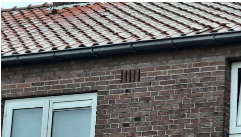
Voor gierwaluw, huismus en vleermuizen geschikte ruimtes onder dakpannen, achter dakgoten en in ventilatievoegen binnen complex 544. Foto: M.M. Bouwmeester | Ecoresult B.V.
