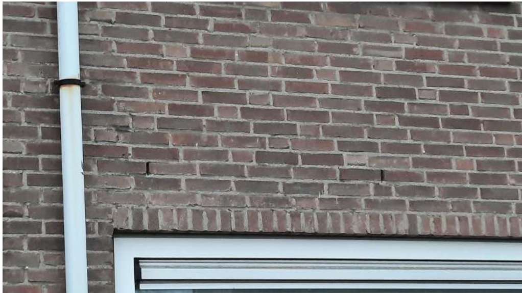
Detail van een gevel in complex 545. De open stootvoegen bieden vleermuizen toegang tot de spouw. Foto: M.M. Bouwmeester | Ecoresult B.V.
