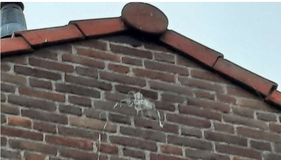
Afbeelding 20: Een voor gierzwaluw geschikte kopse gevel in complex 539 Foto: M.M. Bouwmeester | Ecoresult B.V.
