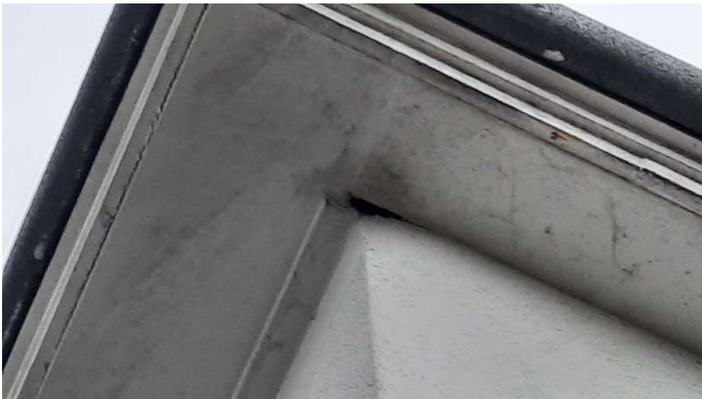
Kier tussen de dakoverstek en de gevel in complex 540. Deze biedt toegang tot eventueel aanwezige verblijfplaatsen van vleermuizen. Foto: M.M. Bouwmeester | Ecoresult B.V.
