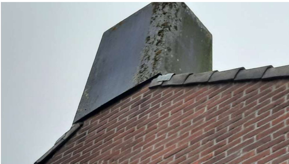
Voor vleermuizen geschikte ruimtes onder de schoorsteenopverkapping en onder de kantpannen binnen complex 541. De ruimte onder de kantpannen is tevens geschikt voor gierzwaluw of huismus. Foto: M.M. Bouwmeester | Ecoresult B.V.
