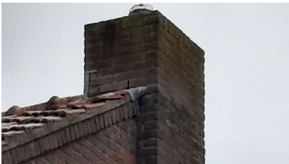
Open stootvoegen in een schoorsteen binnen complex 542. Deze bieden toegang tot potentiële verblijfplaatsen van vleermuizen. Foto: M.M. Bouwmeester | Ecoresult B.V.
