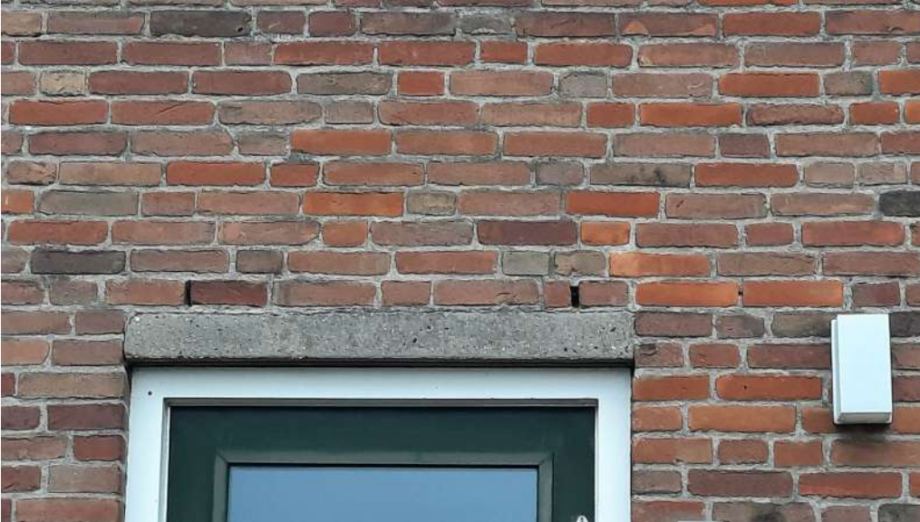
Detail van een gevel in complex 539. De open stootvoegen bieden vleermuizen toegang tot de spouw. Foto: M.M. Bouwmeester | Ecoresult B.V.
