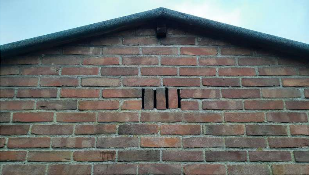
Detail van een gevel van een schuur in complex 544. De ventilatievoegen bieden toegang tot potentiële vlemuisverblijfplaatsen. Foto: M.M. Bouwmeester | Ecoresult B.V.
