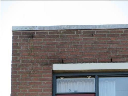
Foto 7: open stootvoegen bij de dakrand van M.H. Trompweg 225a t/m I
