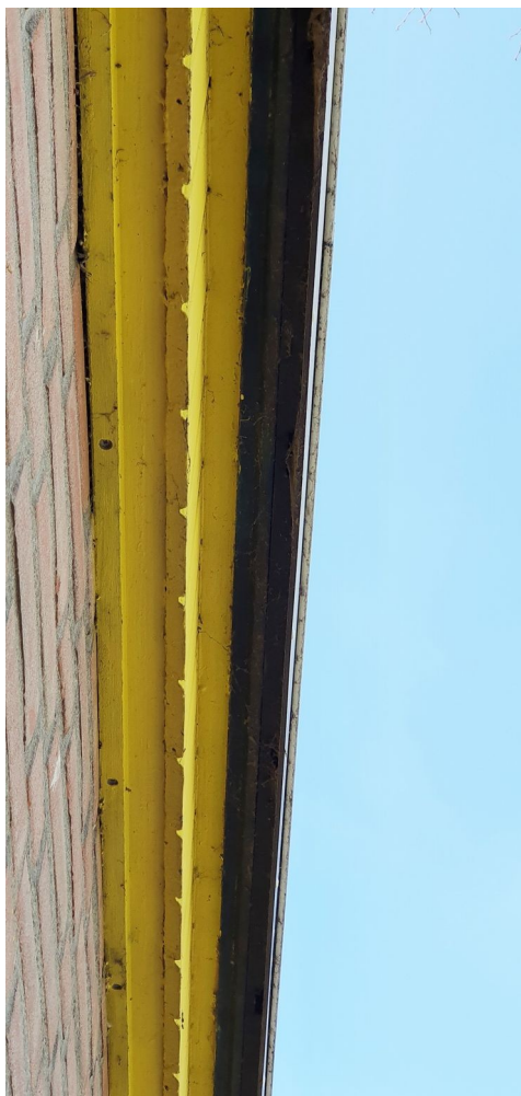
In en om de dakbekisting bevinden zich meerdere openingen en kieren. Foto: K. de Vries | Ecoresult B.V.
