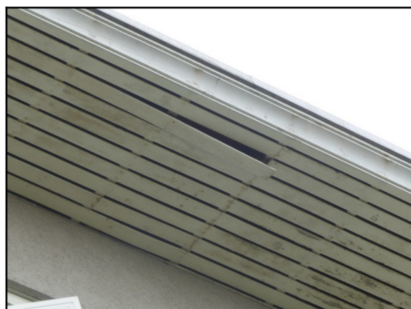
Beschadiging in het overstek van het dak. Foto: C.E. Bakker | Ecoresult B.V.
