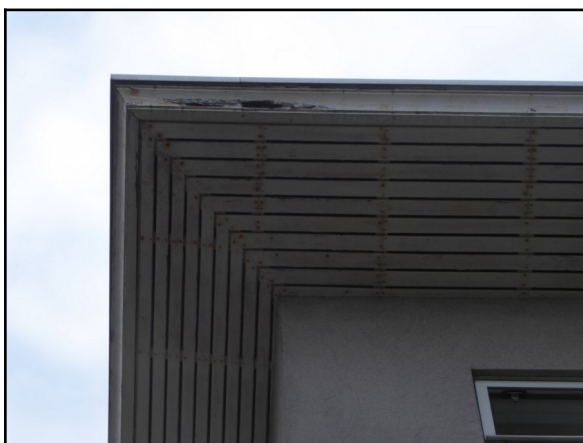
Overstek met latten bij de daken van de complexen. Beschadigingen zijn ook zichtbaar. Foto: C.E. Bakker | Ecoresult B.V.
