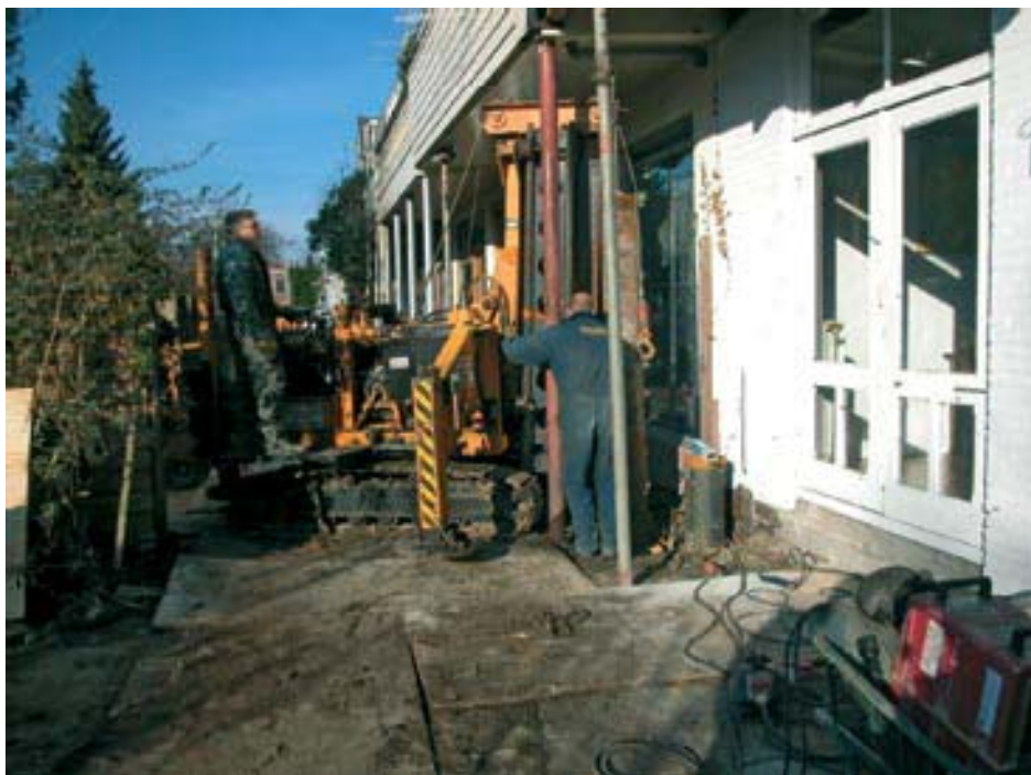
Foto 6 Heiwerkzaamheden aan de Sumatrastraat in Dordrecht (overgenomen uit de brochure Funderingsherstel, ministerie van VROM juli 2005).
