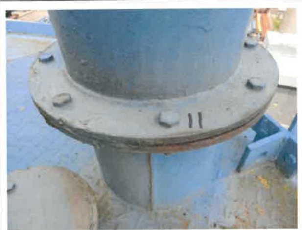
M-011 Pakking (Risicoklasse 1 geldt enkel wanneer de flens aan beide zijde wordt doorgehaald en in zijn geheel wordt verwijderd inclusief de asbesthoudende pakking).
