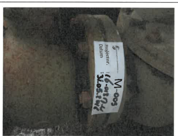
M-005 Pakking (Risicoklasse 1 geldt enkel wanneer de flens aan beide zijde wordt doorgehaald en in zijn geheel wordt verwijderd inclusief de asbesthoudende pakking)
