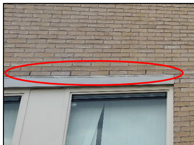
Figuur 5-1. Open stootvoegen bij het hoofdgebouw op de onderzoekslocatie.
