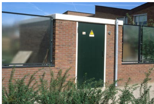
Referentiebeeld: Trafo geïntegreerd in de erfscheiding
