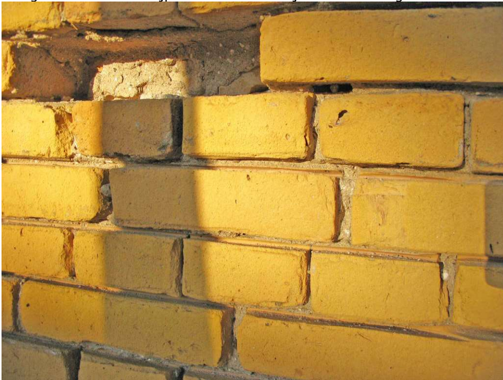
Afbeelding 6: Ernstig verminkt metselwerk door het met een slijptol verwijderen van voegwerk. Achtergevel van een pand aan de Museumstraat, Dordrecht.
