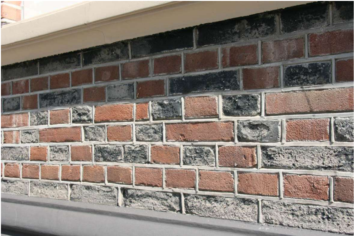
Afbeelding 12: Beschadiging van de metselstenen door te harde reiniging. De bakhuid is verdwenen en de kleur is vervaagd. Vrieseweg, Dordrecht.
